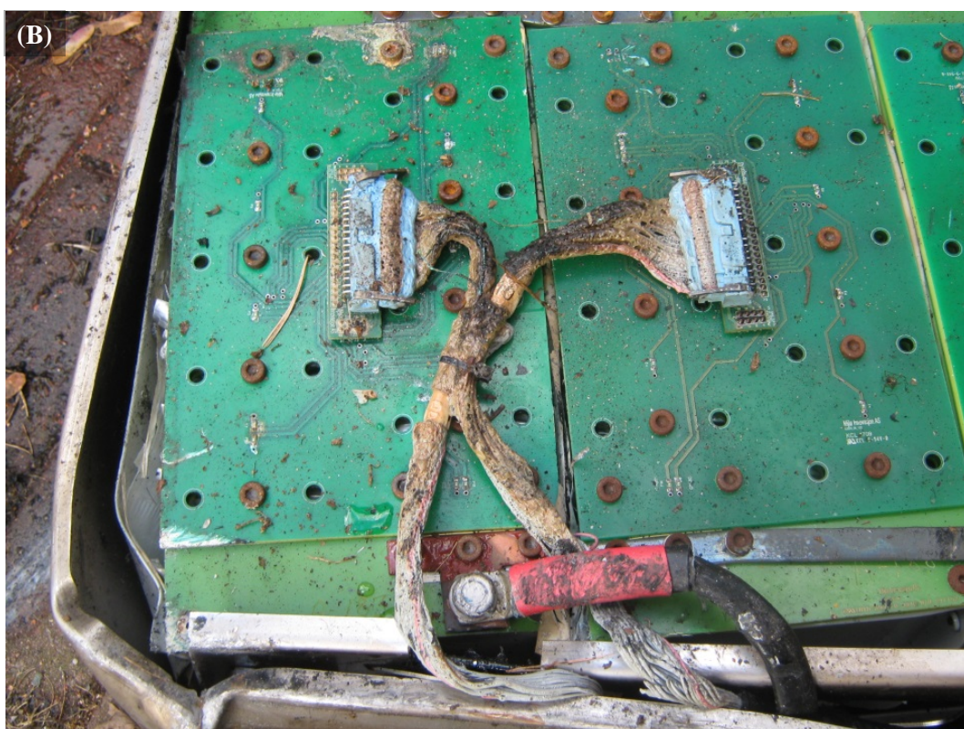
Figur C-2 Bilde (A) og (B) viser de to boksene som utgjorde batteripakken. Det er tydelig at batteriet har blitt utsatt for kraftig varme, ved at kablene er delvis smeltet, men ellers er det ingen tegn til at en brann har funnet sted. Dersom cellene hadde brent, ville batteriet ha hatt tydelige sotmerker. Fraværet av sotmerker tyder på at varme-påvirkningen har skjedd via strålevarme ovenfra, og ikke fra battericellene selv.
