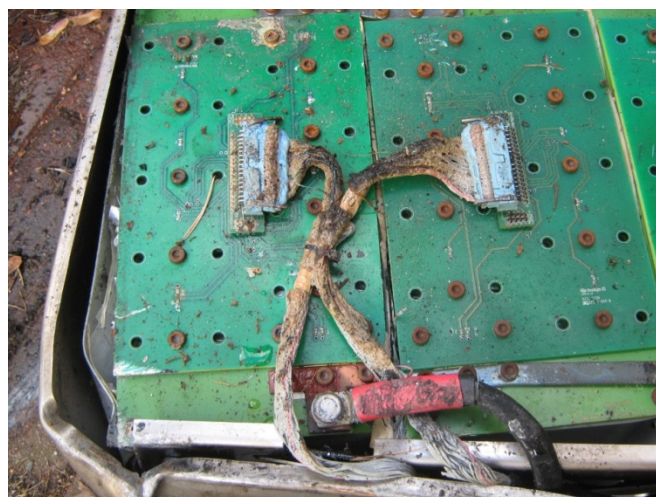
Figur 4-6 En del av batteripakken ca. tre uker etter test. Kablene er delvis smeltet, men ellers er det ingen tegn til at en brann har funnet sted. Dersom cellene hadde brent, ville batteriet ha hatt tydelige sotmerker. Fraværet av sotmerker tyder på at varmepåvirkningen har skjedd via strålevarme ovenfra, og ikke fra battericellene selv.
